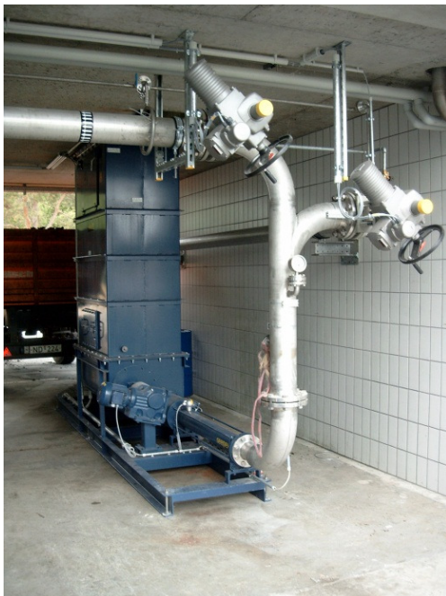
Dickstoffpumpe mit Vorlageschacht und Brückenbrecher
