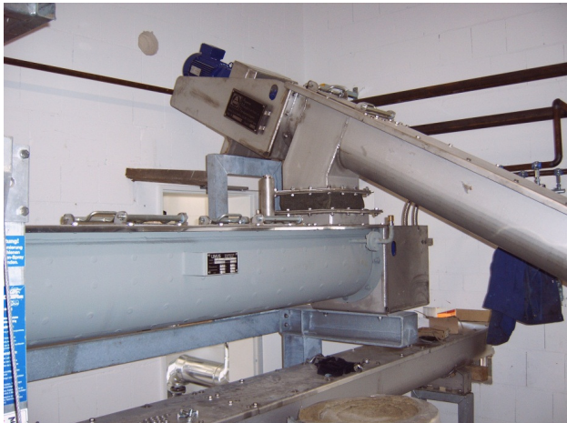
Zwischenschnecke mit Nach-trockner und Kühlschnecke
