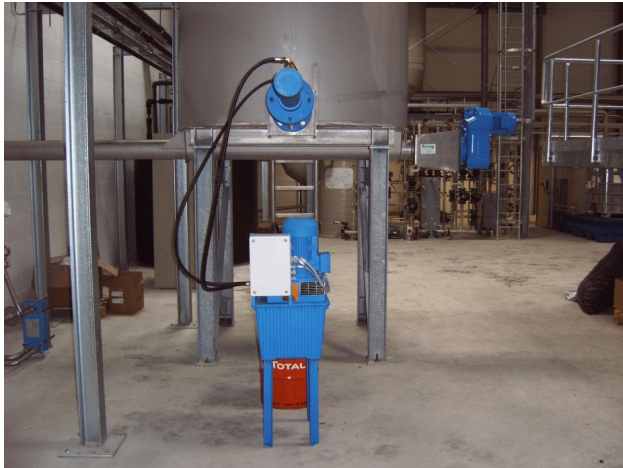
Schlamm-silo mit Austragsschnecke
