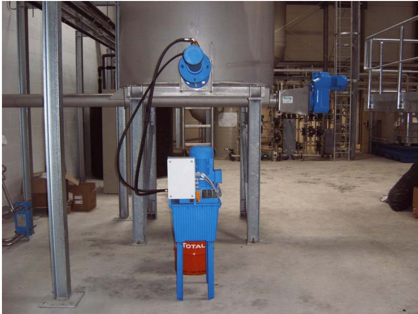
Schlamm-silo mit Austragsschnecke
